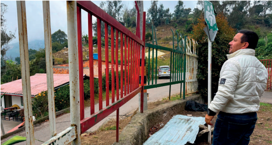
Estado de cerramiento de la escuela antes de la obra interinstitucional.
